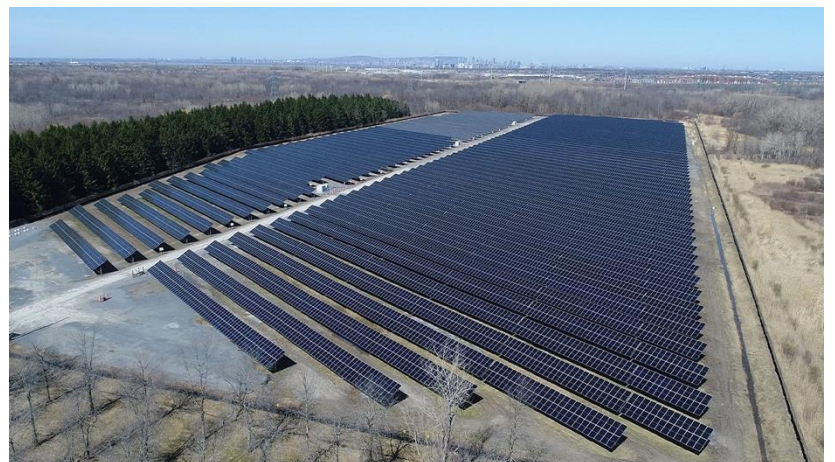
Centrale solaire Gabrielle-Bodis – 2021 – Hydro-Québec
